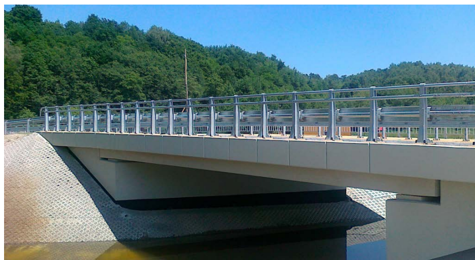
Most na rzece Korzenna w Bogorii uszkodzony w wyniku deszczy nawaalnych w maju 2010 roku, oddany do użytku w czerwcu 2012 roku.
