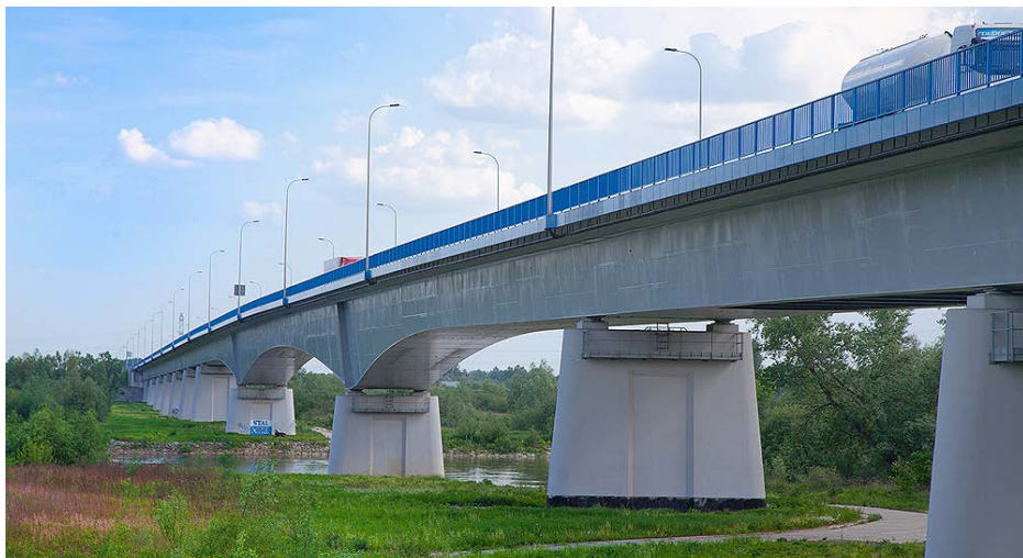
W listopadzie 2014 roku oddano do użytku most na Wiśle koło Połańca. Wspólnie z mostem na rzece Breń, była to w tamtym okresie największa inwestycja drogowa w województwie świętokrzyskim.
