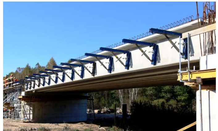
W ciągu drugiego odcinka obwodnicy most w budowie o długości 31 m na rzece Desta.
