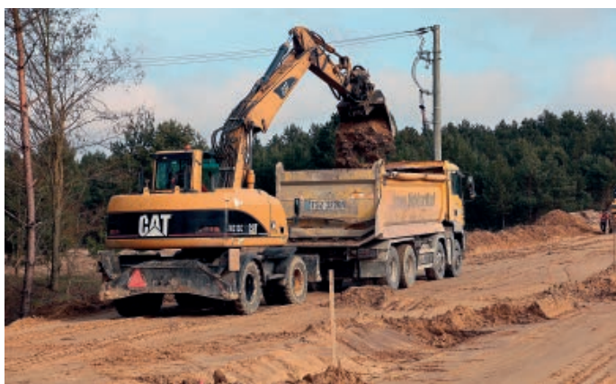
W trakcie profilowania ciągu głównego drogi i kopania rowu dla zabezpieczenia prac przed deszczem.
